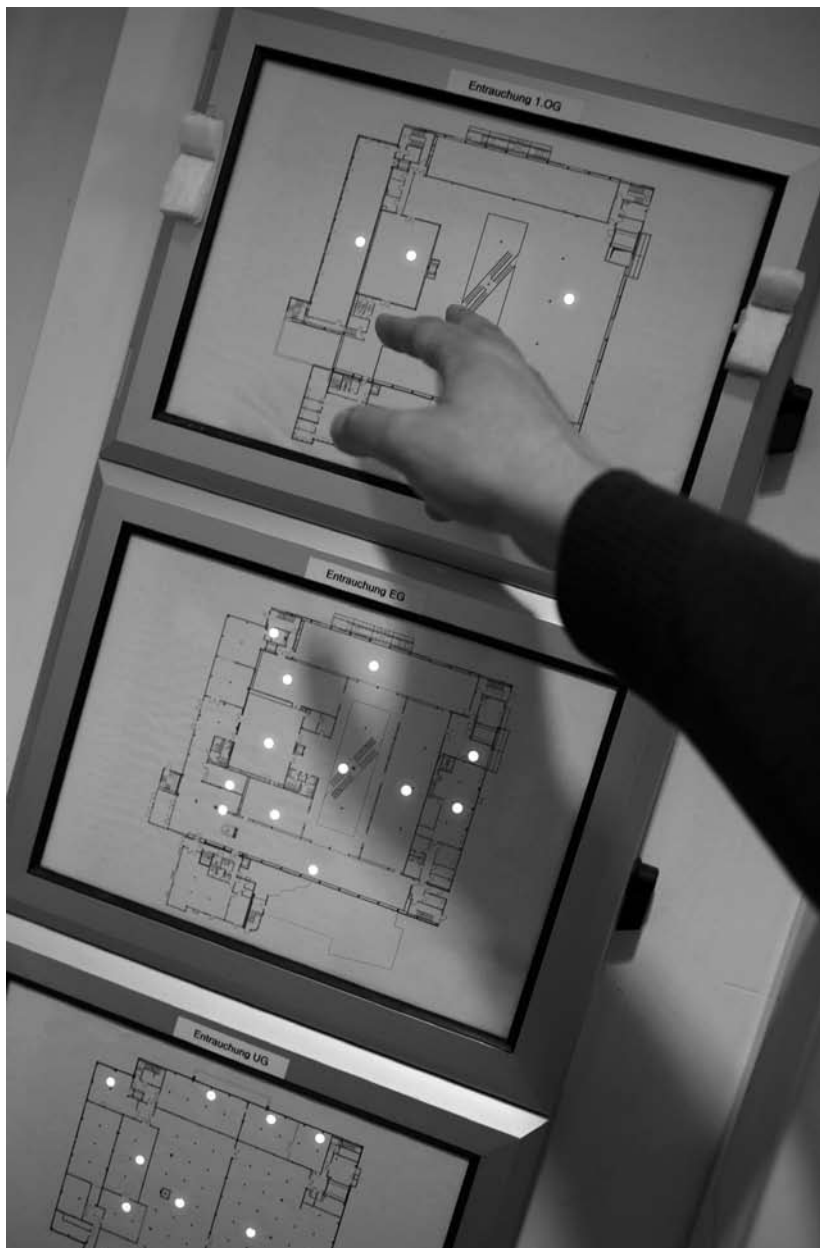
Abb. 4: Moderne Sicherheitstechnik ist in allen Bereichen unverzichtbar.
